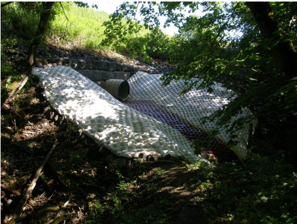
Fult och störande befintligt erosionsskydd i östra ravingrenen öster om Hilleforskvaren inom Natura 2000 och naturreservat.
